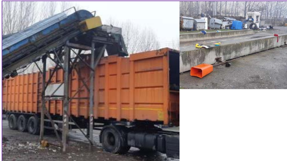
Figura 4-2: Echipamente tehnologice stație de transfer Brezoi
